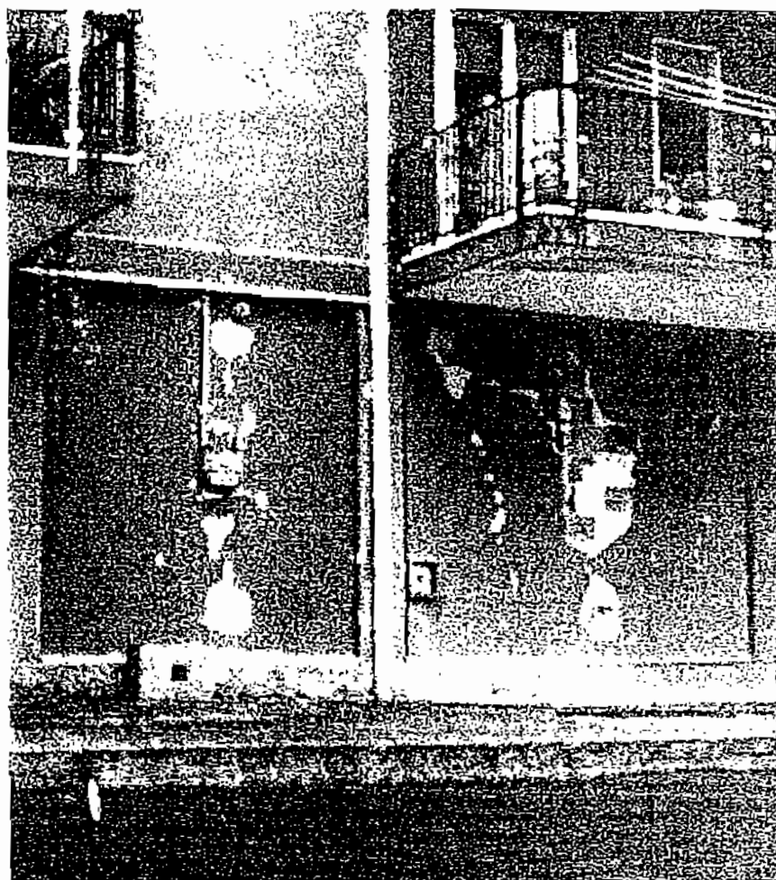
Figura 4.33 Lesioni gravi in tamponature deboli. Livello del danno alle tamponature: D4 (Umbria, 1997)
