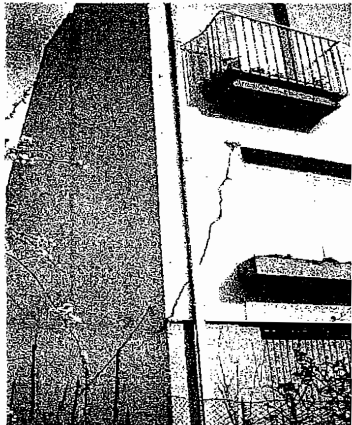
Figura 4.9 Lesione diagonale (tipo 3) in un maschio murario, con dislocazione alla base. Livello del danno: D3 tendente a D4 (Fabriano, 1997)
