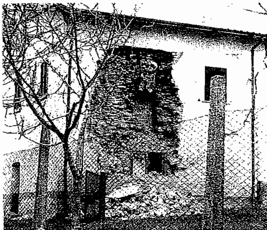
Figura 4.14 Crollo parziale di muratura a sacco in corrispondenza di vecchie aperture, per distacco esteso del paramento esterno (tipo 12); a destra si sviluppa una grave lesione diagonale (tipo 3) con dislocazione di diversi cm di buona parte della parete. Livello del danno: D4 (Busche, PG, 1996)
