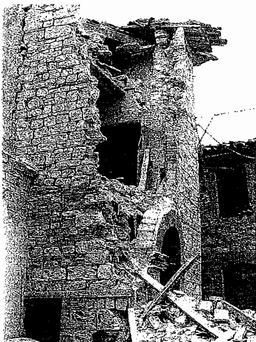
Figura 4.24 Crollo parziale di muratura e copertura. Livello del danno alla parete: D4-D5. Livello del danno alla copertura: D4-D5 (Busche, PG, 1998)
